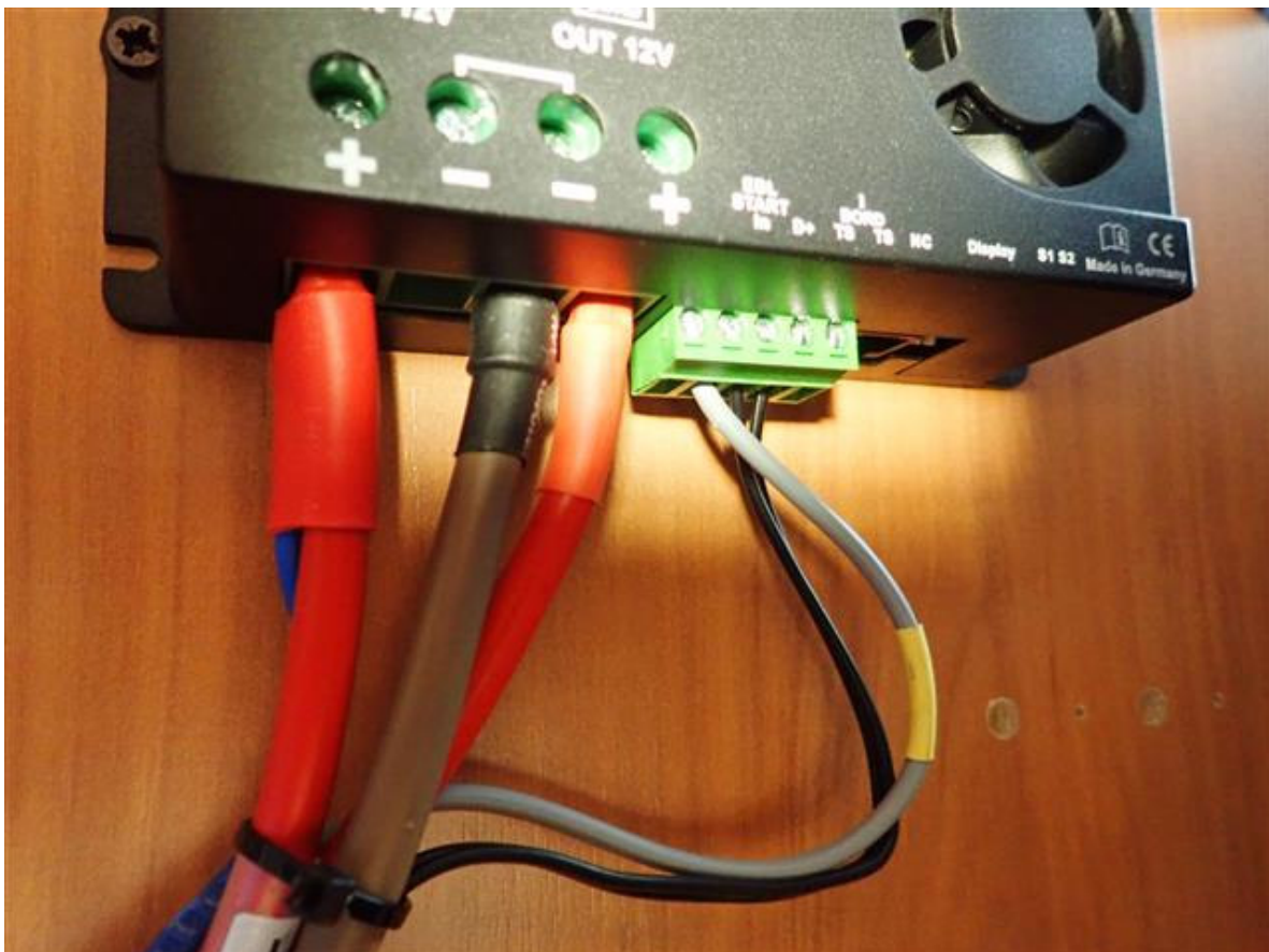
cablaggio collegato a booster, cavo grigio D+ , cavetto nero sensore temperatura
