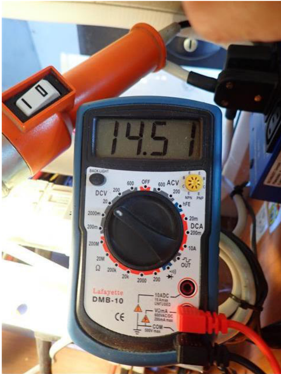
tensione di carica BS con booster in funzione
