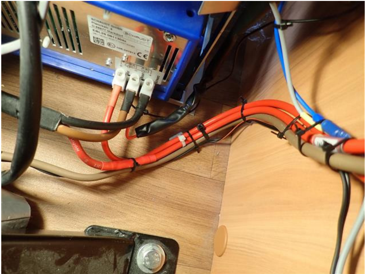
cablaggio collegato a centralina
